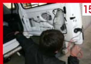
15 ドアの内張を剥がし、余分な配線が出ないように、キレイにしまっていく。
