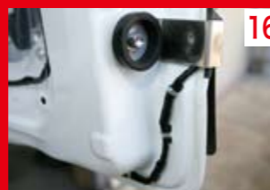
16 どうしても隠れない配線はコイルゲートチェーンで保護。クリップで固定する。
